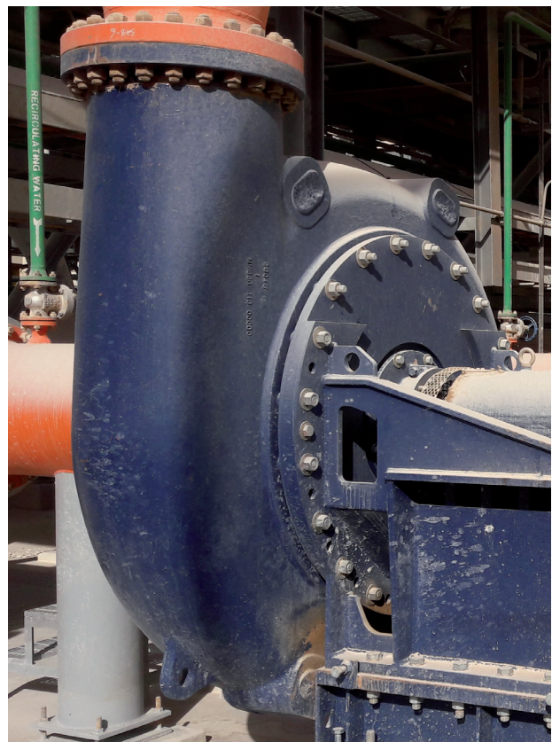
Una bomba millMAX instalada en una planta de fosfato en Arabia Saudita
