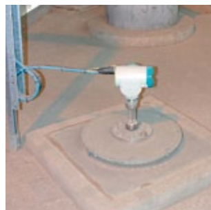
Люк силоса и датчик уровня Nivopilot на крыше силоса
